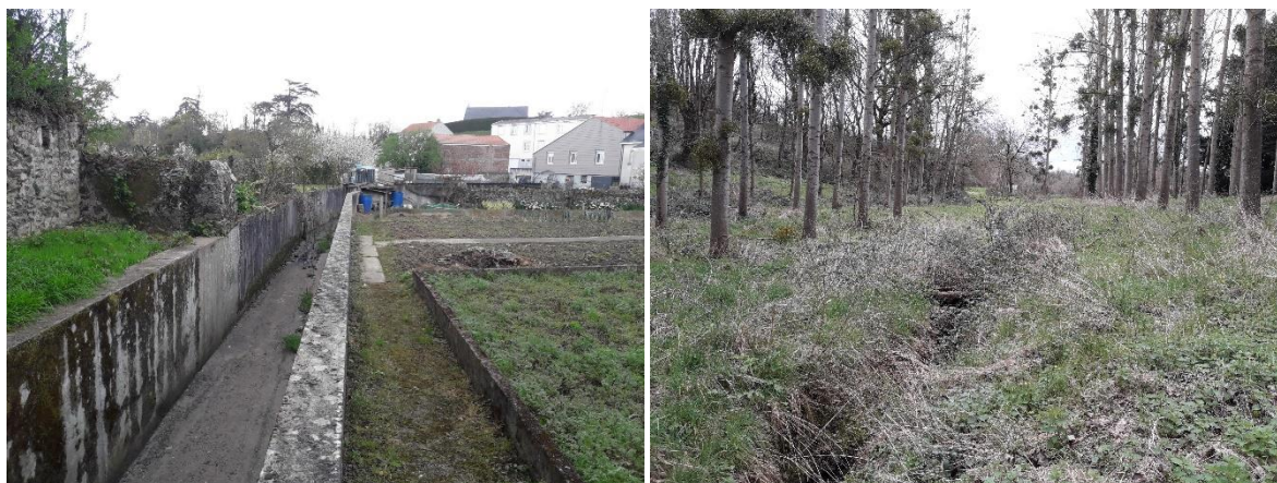
Figure 163 : Situations dégradées - Source : HARDY ENVIRONNEMENT
