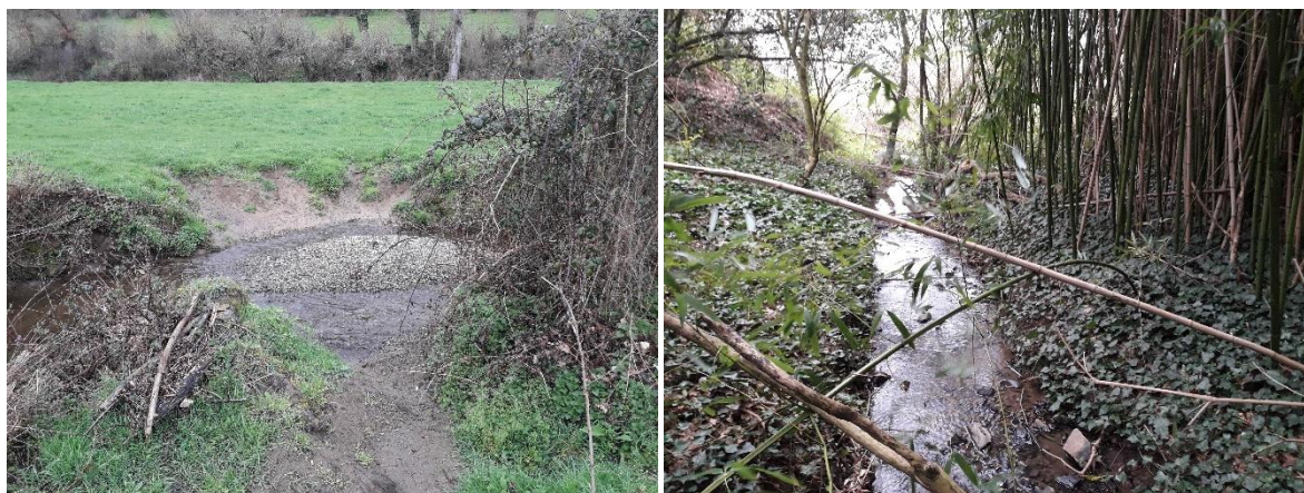
Figure 152 : Situations dégradées - Source : HARDY ENVIRONNEMENT
