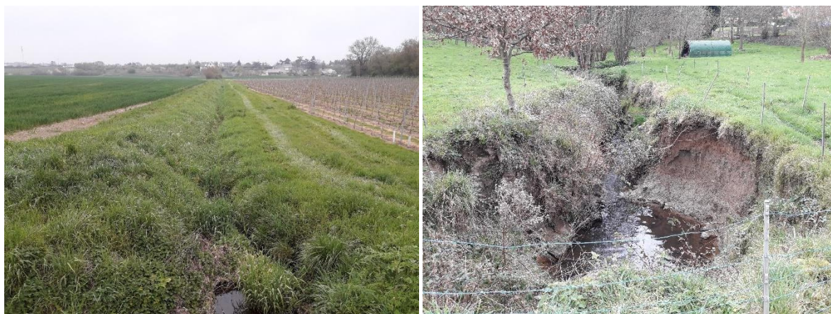
Figure 147 : Situations dégradées - Source : HARDY ENVIRONNEMENT
