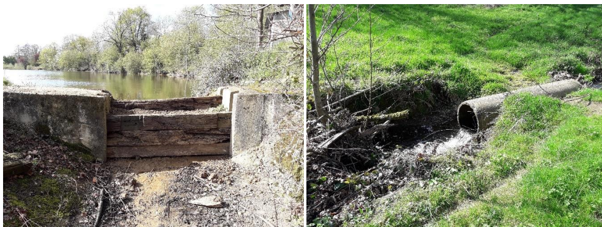
Figure 156 : Situations dégradées – Source : HARDY ENVIRONNEMENT
